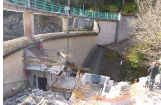
Amélioration du dispositif de délivrance de débit minimum biologique sur le barrage de Brumessanges (Tarentaine)
